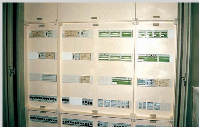
2 Reiheneinbaugeräte im Schaltschrank sind das Kernstück des instabus EIB-Systems
