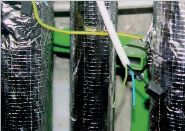
❶ Unzureichend gesicherte Kabelenden führten zu einem Unfall durch Stromschlag
