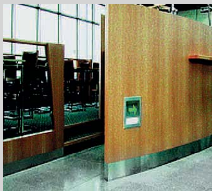
4 Bodennahe Sicherheitsleuchten im Flughafen Dortmund
