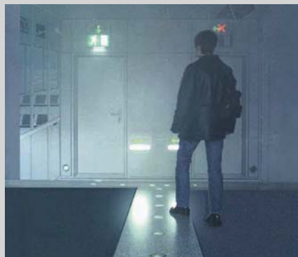
3 Im Ernstfall ist die Situation noch ungünstiger als in dieser Simulation: Die Türleuchte ist nur schwach erkennbar, die Wandeneinbauleuchten in Bodennähe bereits besser. Die Bodeneinbauleuchten zeigen gut erkennbar den Fluchtweg.
