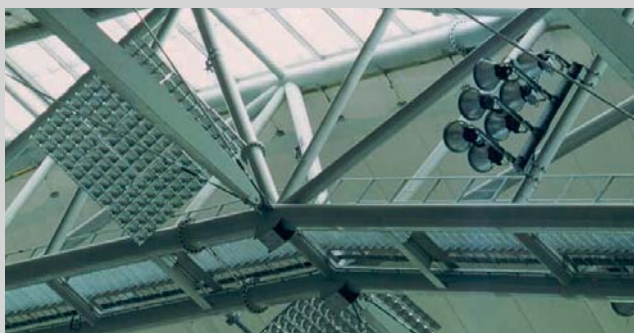
2 Die Lichtwerfer und Umlenkreflektoren wurden eigens durch Computersimulationen berechnet um die gleichmäßige Lichtverteilung über die gesamte Nutzfläche zu erreichen
