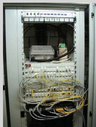
4 Rack mit Aktivkomponenten Breitband und Patch-Panels
