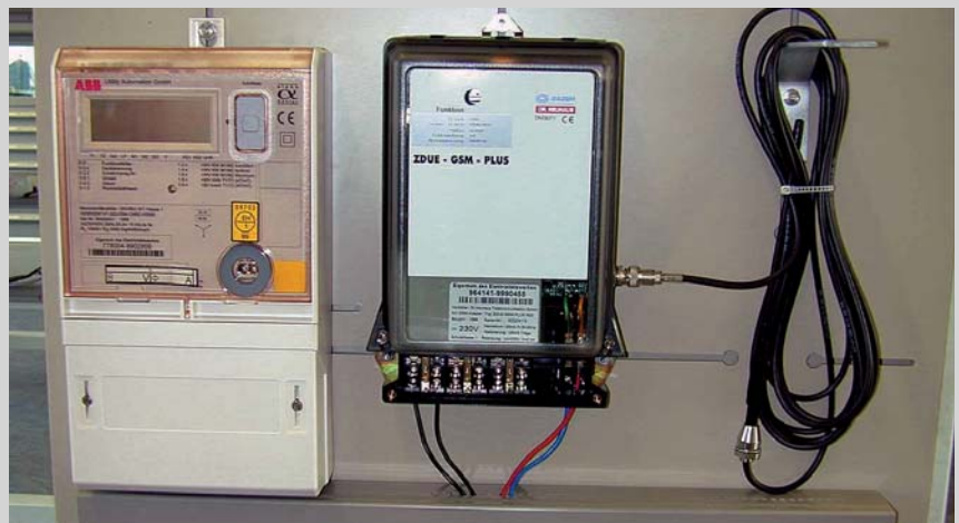
4 Lastgangzähler mit Mobilfunkanbindung
