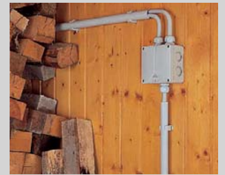
2 Feuergefährdete Betriebsstätten stellen besondere Anforderungen an die Elektroinstallation (z. B. IP4X oder IP5X)
