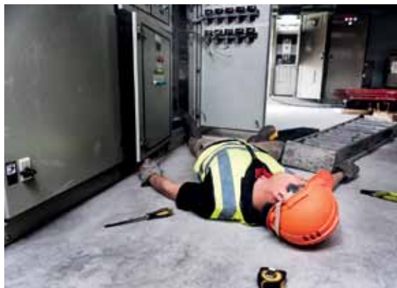
Verletzter Servicetechniker in einem Kontrollraum
