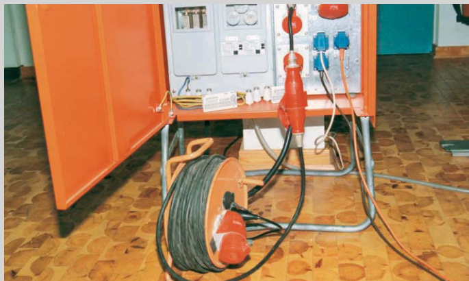
4 Unzulässige Adapterleitung von 32-A-CEE-Drehstrom-Stecker auf 16-A CEE-Drehstrom-Kupplungsdose, betrieben zwischen Baustromverteiler und Leitungsroller (Kabeltrommel)
