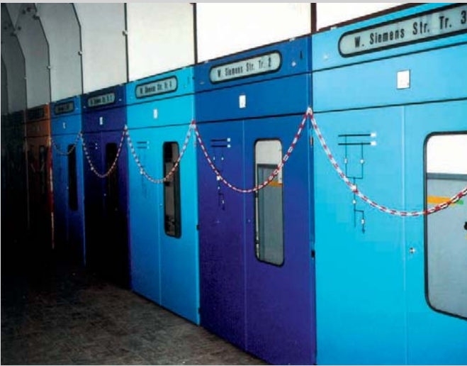
② Farblich abgesetzte Schaltfeldtüren können Verwechslungen vorbeugen
