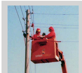
1 Bei Arbeiten an unter Spannung stehenden Freileitungen sind die erforderlichen Schutzausrüstungen einzusetzen
