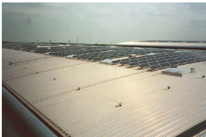
4 Ausschnitt aus dem Solar-Dach der Messe München (1.016 kWp, ca. 1 Mio kWh pro Jahr senken den CO 2 -Ausstoß um etwa 1000 Tonnen)
