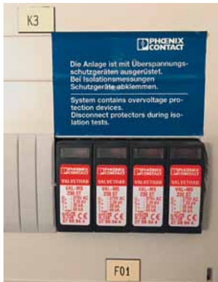
Überspannungsschutz in einer Unterverteilung
