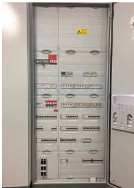
Überspannungsschutz in einer Hauptverteilung
