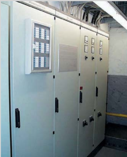
④ EIB-Steuerung (Teilansicht)
