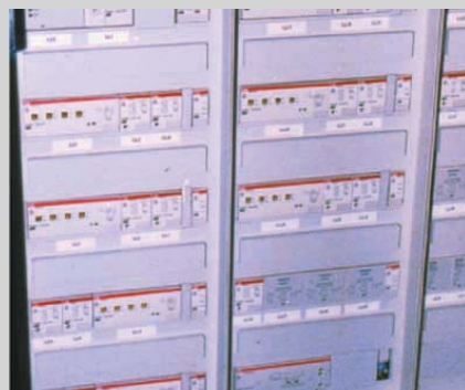
10 Einsatz der Bus-Überspannungs-Ableiter in den EIB-Verteilern
