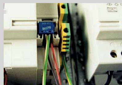
6 Bus-Überspannungs-Ableiter und dessen Anwendung zum Schutz einer Bus-Leitung in der EIB-Verteilung
