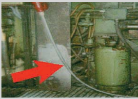
❶ Beschädigte PVC-Anschlussleitung
