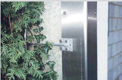
⑥ Verbindung von Blumenklettergerüst und Türblechkantenschutz mit dem Ableiter
