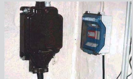
⑧ Installation von Blitzstromableitern am Hausanschlusskasten
