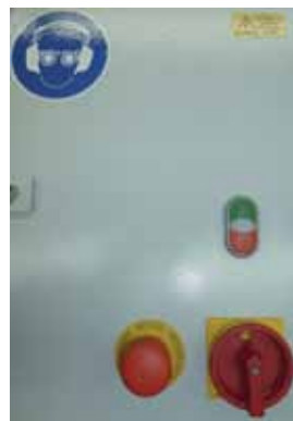
2 Not-Halt-Taster und Hauptschalter sind in den gleichen Farben ausgeführt
