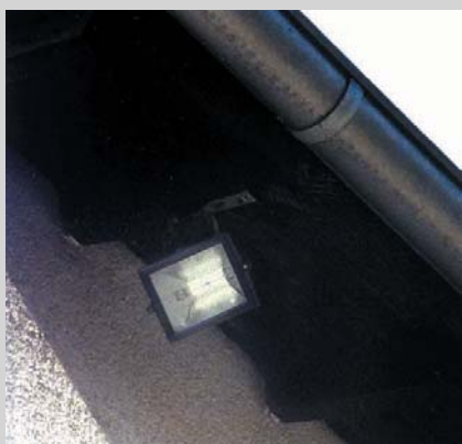
⑤ Ungenügender Sicherheitsabstand zwischen Elektrostrahler und Dachrinne
