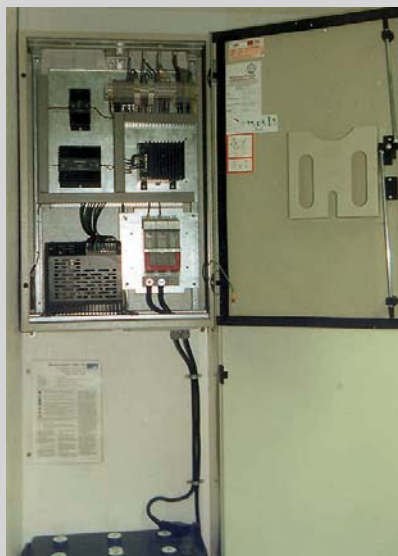
③ Die Versorgung bei Netzausfall erfolgt über Blei-Gel-Akkumulatoren 2 x 12 V 180 Ah
