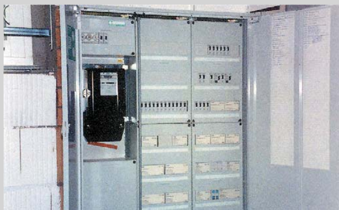
② Kompakte Intelligenz auf kleinem Raum: die PHC-Moulde im Ver-teilerschrank
