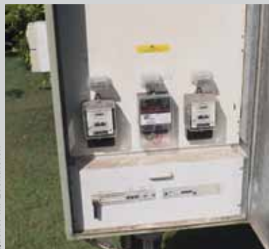
2 Typische Zähleranlage mit Hauptverteilung in Australien
