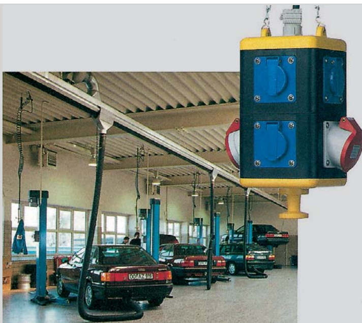
1 In Autoreparaturwerkstätten und an ähnlichen Arbeitsorten bieten sich zur Energiebereitstellung Hängeverteiler an
