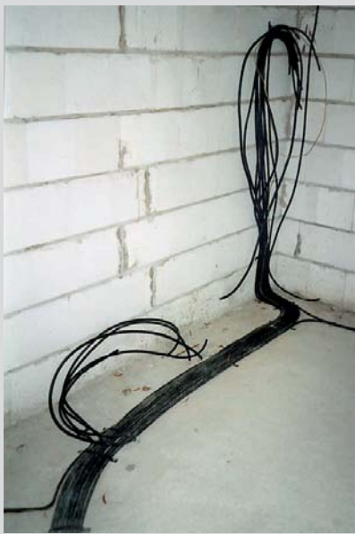
⑤ Leitungsbündelung, auf der Rohdecke mit losen Anschlußleitungen für die Anschlüsse in noch nicht vorhandenen Trennwänden: Auch hier ist ein mechanischer Schutz erforderlich
