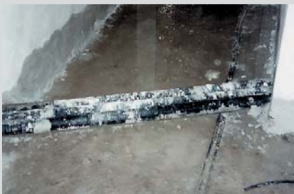
2 Nicht ungewöhnlich: Auf das Leitungsnetz drücken Bauteile und können Schäden z. B. durch Verformungen verursachen
