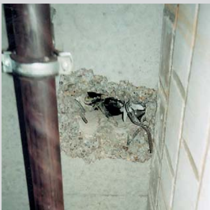
3 Bei einer Rohrbefestigung zerstörte Leitungen im Fußboden oberhalb der Kellerdecke
