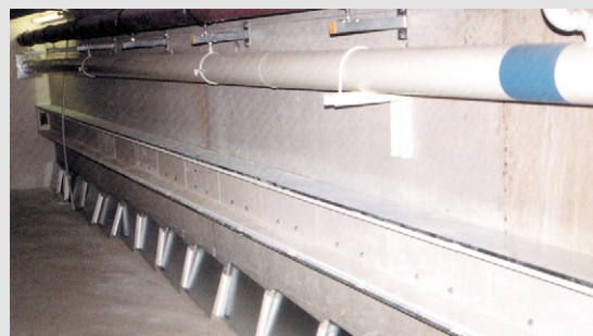
2 Brandschutzkanal im Einsatz Teil eines von der mittelständischen Fa. Elektro Stiller installierten 100 m langen Kanals für die Notstromversorgung des Verwaltungsgebäudes der Deutschen Messe AG in Hannover. (Fotos: REHAU)
