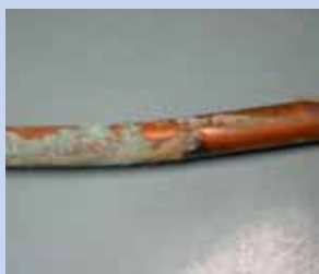
1 Schäden an einer Wasserleitung in einem Altenpflegeheim
