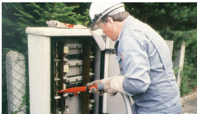
① Bei Reinigungsarbeiten unter Spannung ist die persönliche Schutzausrüstung zu benutzen
