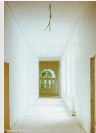
② Im ersten Bauabschnitt wurde das EIB-System zur Beleuchtungssteuerung, zur Steuerung der Markisen und zur Überwachung der Haustechnik eingesetzt
