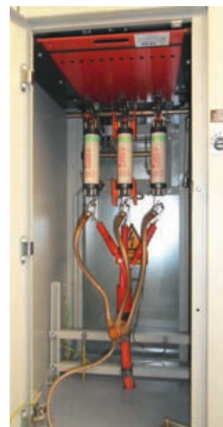
10 kV: eingebaute Erdungs- und Kurzschließeinrichtung
