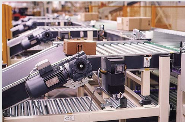
1 Konsequente Dezentralisierung mit AS-i-Motorstartern im BMW-Versorgungszentrum Wackersdorf/Bayern
