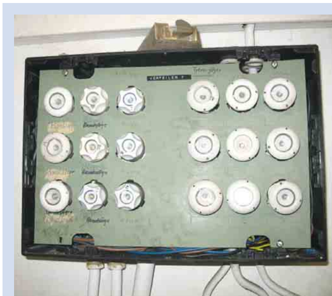
1 Lediglich mit einer Sichtkontrolle sind Schäden oft nicht erkennbar
