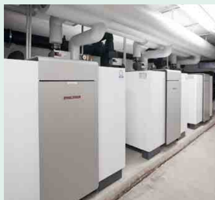
1 Installiert sind insgesamt vier Sole/Wasser-Wärmepumpen der Baureihe WPF 27 die als kaskadiertes System arbeiten
