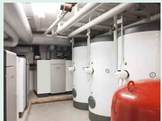
2 Die drei vorhandenen Warmwasserspeicher der alten Anlage blieben erhalten und werden weiterhin genutzt
