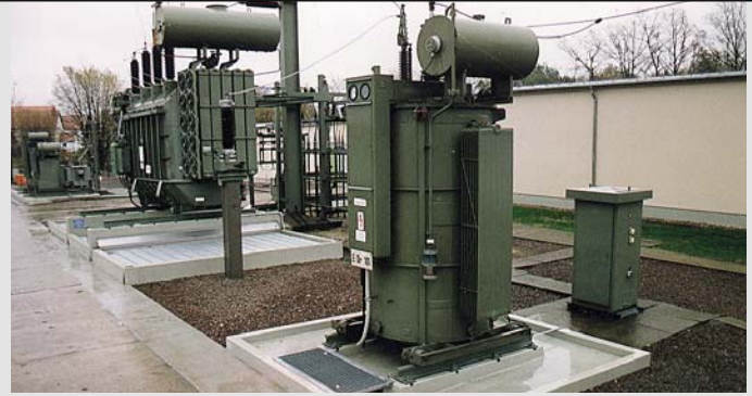
⑤ Fabrikfertige Auffangwannen für Großtransformator und Erdschlußspule
