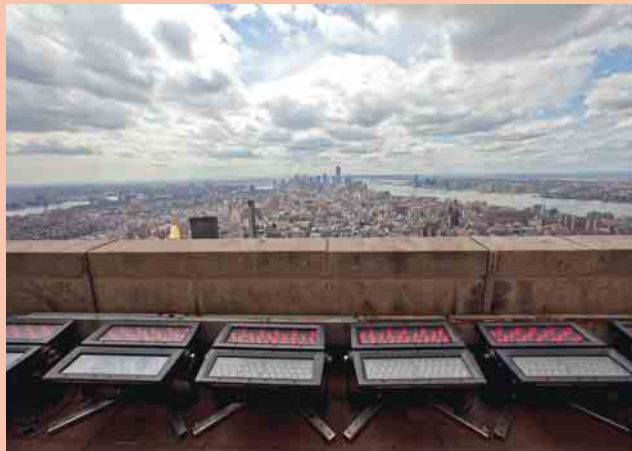
Am Empire State Building kommt eine dynamische LED-Beleuchtung zum Einsatz, die ein Ansteuern von Fassade und Mast in Echtzeit ermöglicht
