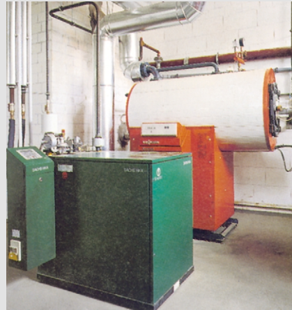
7 Heizungskeller eines Technologiezentrums: Das BHKW im Vordergrund liefert das ganze Jahr Strom und Wärme (vgl. Bild 2). Der dahinter installierte Kessel deckt im Winter den Heizenergiebedarf mit mehr als zwanzigfach größerer Leistung ab. (Quelle: Senertec)
