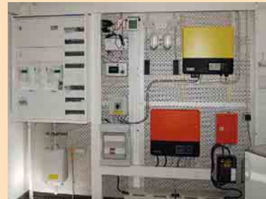
4 Keller der e-Villa – das „Kontrollzentrum“ der Stromerzeugung
