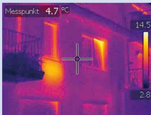
2 Sichtbare Wärmebrücke einer Heizungs-nische
