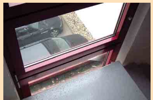
2 Fachkompetenz zeigen: fehlende Trittsperre kann im Panikfall zu schweren Verletzungen führen
