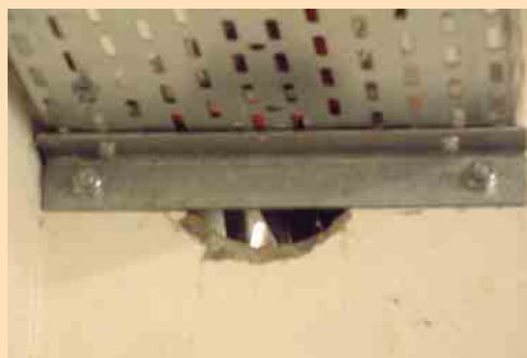
1 Fehlendes Brandschott – typische Situation zum „Übersehen“
