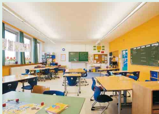
1 Die neue Beleuchtungsanlage ist ausgestattet mit direkt/indirekt strahlenden T5-Raster-Pendelleuchten mit integrierter tageslicht- und präsenzabhängiger Regelung
