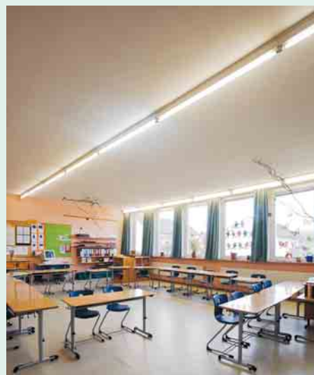
2 In dem Klassenzimmer mit einer fast 40 Jahre alten Beleuchtungsanlage herrschen schlechte Seh- und Lernbedingungen – und das bei einem hohen Energieverbrauch
