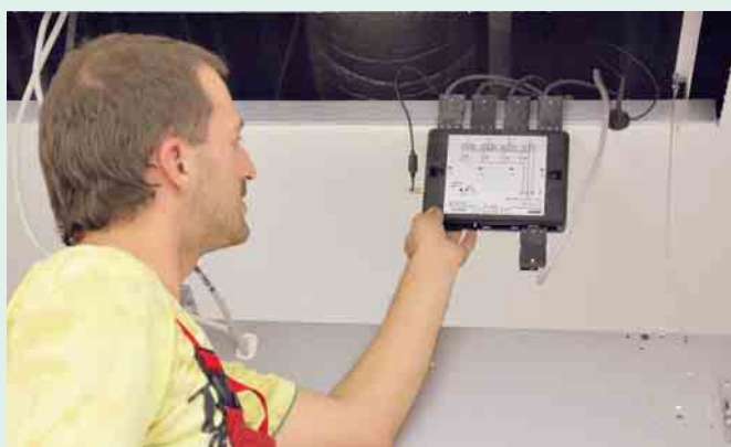
④ Die batterielosen Lichtschalter senden beim Tastendruck ein Signal zum Funkempfänger (Winsto-Verteilerbox) in der Zwischendecke, der den Schaltimpuls an die Deckenlampen weiterleitet
