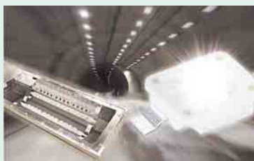
6 Der Thüringer Schmücketunnel auf der A71: Die Beleuchtungskörper sind mit LED bestückt
