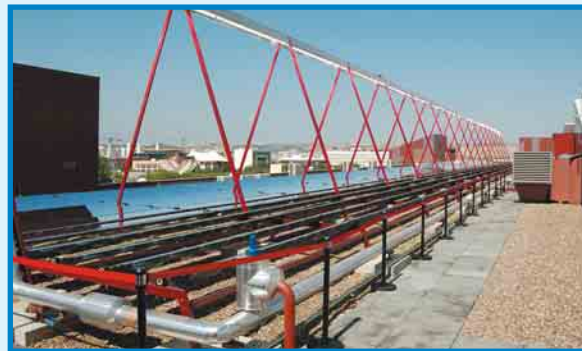
4 CSP-Anlage aus Fresnelkollektoren
