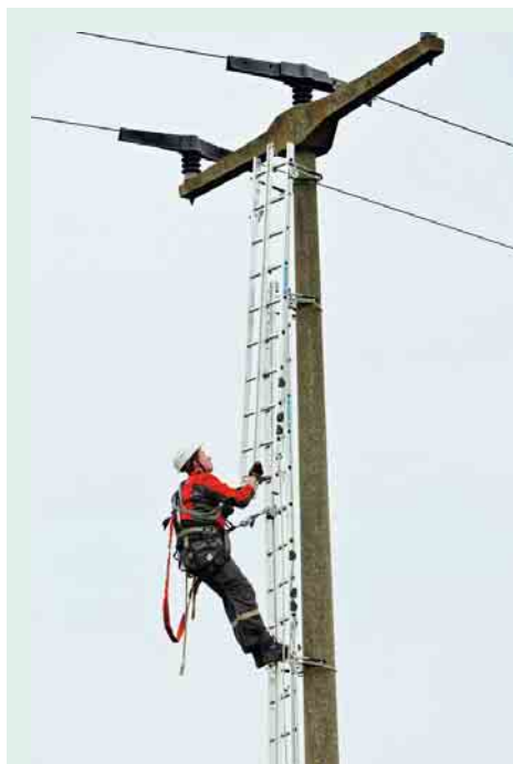
① Nachgerüstete Kunststoffhauben schützen Vögel davor, tödliche Erd- oder Kurzschlüsse zu verursachen – die neue Maststeigleiter hat dabei bereits gute Dienste geleistet
