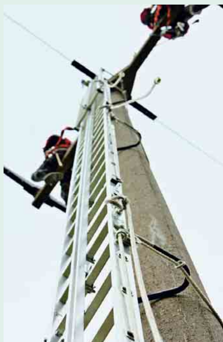
② Die modular aufgebaute Leiter ist mit einer mittig angebrachten Steigschutzschiene versehen und mit einem speziell konstruierten Mastbügel sowie einer durch Schotteklemmen fixierten Flechtleine am Mast gesichert
