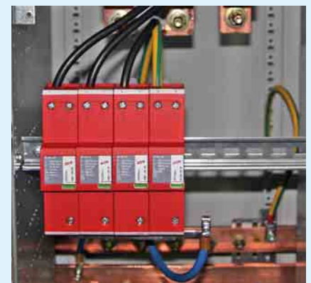
6 Anwendung koordinierter Blitzstrom-Ableiter Dehnbloc Maxi 1 760 für 400/690-V-Systeme mit gekapselter Funkenstrecke
