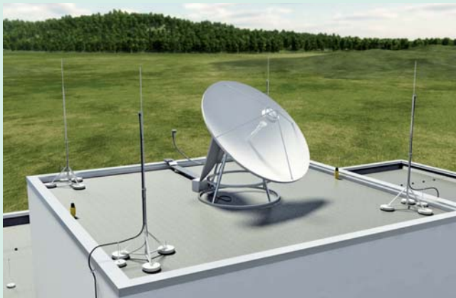
2 Bei falsch installierten Fangeinrichtungen kann es zu einer Beeinflussung der Sende- und Empfangssignale kommen
