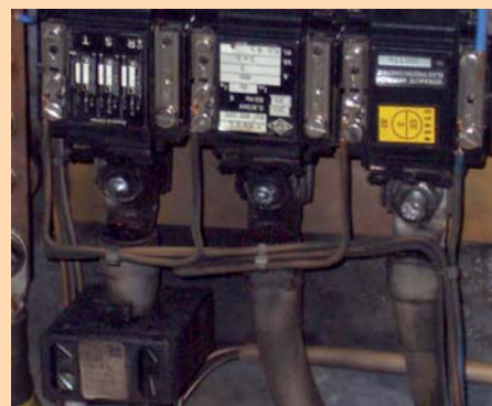
Wandlermessschrank nach dem Kurzschluss
