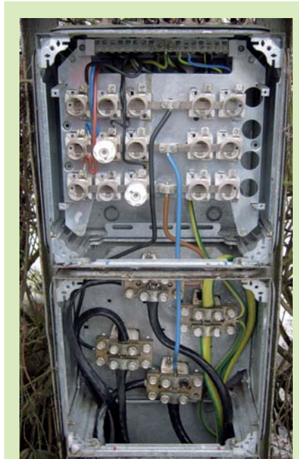
❶ Im oberen dieser zwei SNV-Kästen möchte der Anfragende einen Kleinverteiler installieren, in dem u. a. ein Zwischenzähler untergebracht ist
