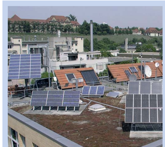
1 Verschiedene Solaranlagen inklusive Photovoltaik auf dem Dach des etz Stuttgart
