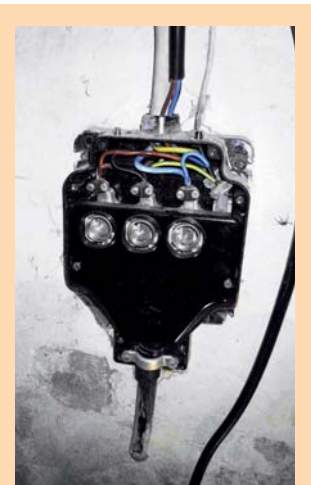
Hausanschlusskasten mit provisorischer Einspeisung
