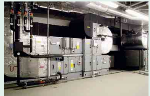
④ Insgesamt sorgen 18 Zu- und Abluftgeräte für optimales mediterranes Klima im Einkaufszentrum
