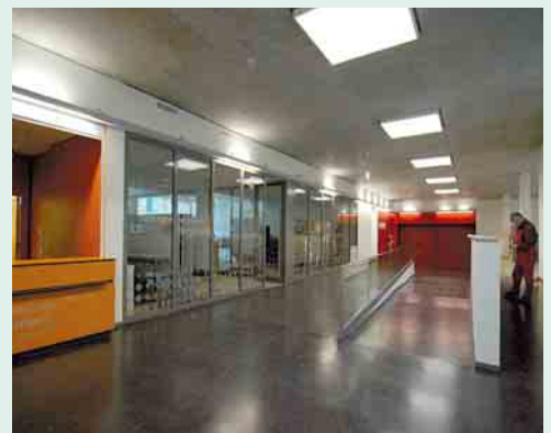
2 Beleuchtungsanlage im Foyer des Multifunktionsbaus
