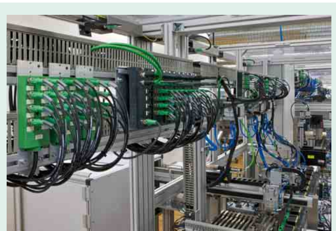
1 Komponenten der Systemverkabelung weisen hohe Schutzarten auf und trotzen Ölen, Wasser oder Stäuben
